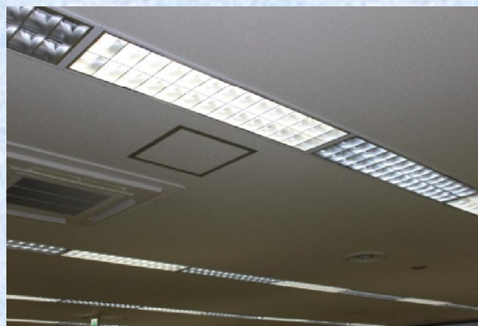
当金庫はポイントで、本部営業室のLED照明を導入しました
